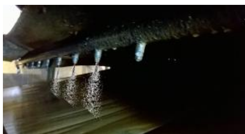
Figura 3 – Tubo e bicos de spray de lavagem dos tecidos filtrantes. Fonte: Dados da pesquisa (2017)
